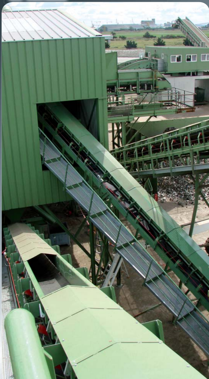
Ligne de tri métaux non ferreux 17 convoyeurs et 2 tours GDE - Saint-Nazaire
