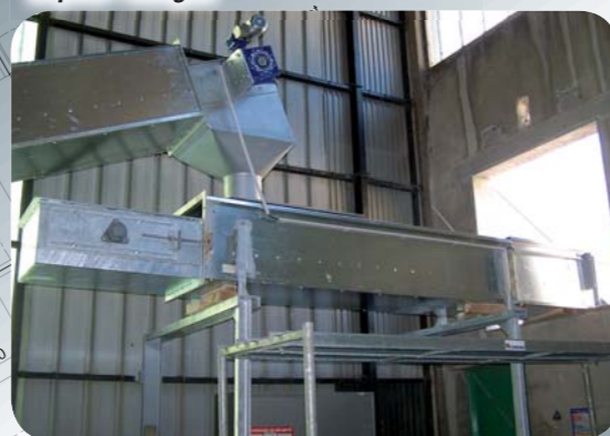
Convoyeurs à cendre sortie chaudière bois Hopital - Valogne
